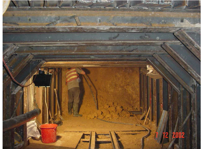
圖 5：在與蒲崗村道交界的慈雲山道進行人手開挖隧道工程，以安裝直徑 1,000 毫米的食水管及直徑 800 毫米的海水管
