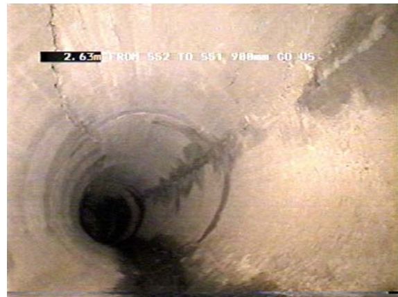
Plate F4 Longitudinal Fracture
