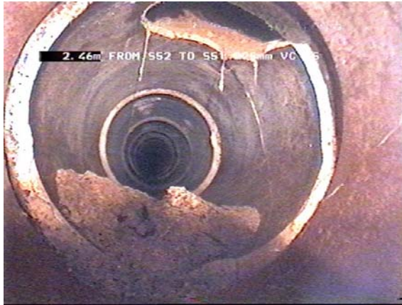
Plate F1 Missing Piece of Pipe Wall
