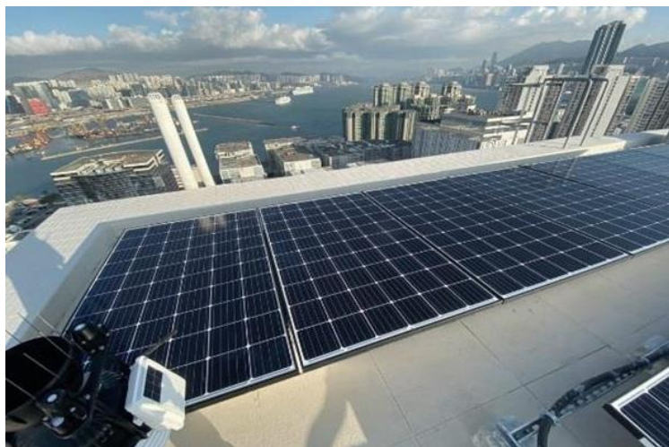
附設於住宅大樓屋頂的光伏板
