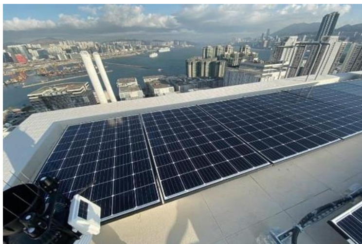
附设于住宅大楼屋顶的光伏板
